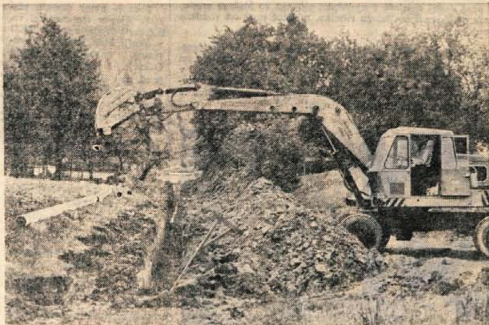
Minull teder so v Stražišču začeli z izkopom za glavni cevovod proti Žabnici — Foto: F. Perdan
