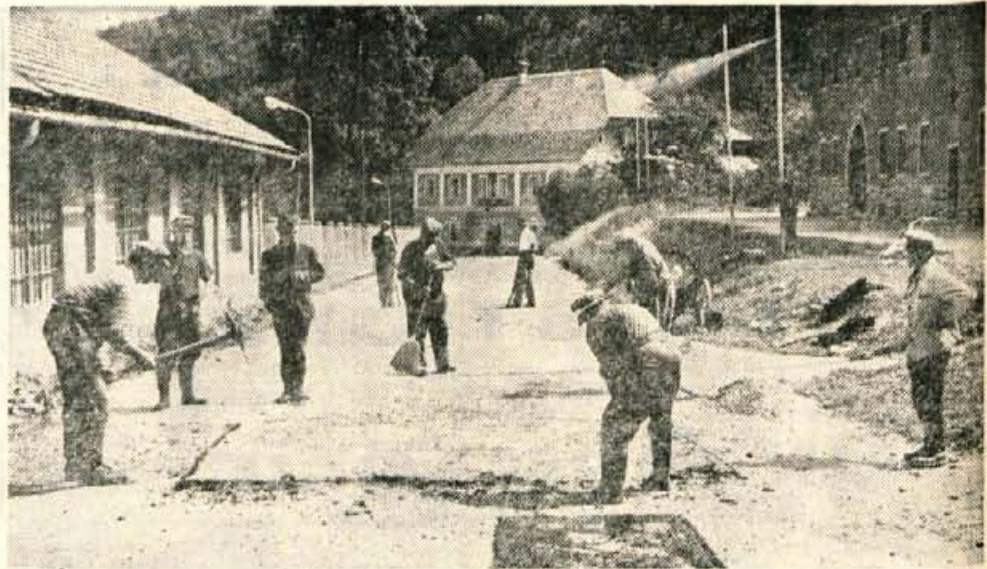
Cestno podjetje Kranj je v sredo krpalo še zadnje luknje v Kropli na cesti Kropa—Radovljica. — Foto: F. Perdan
