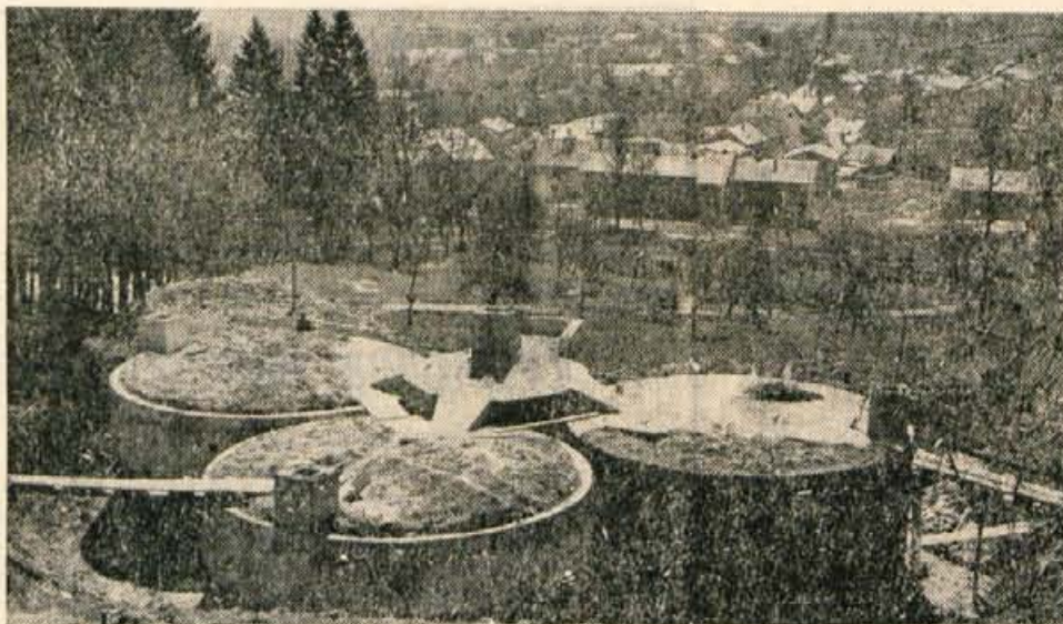
Približno čez en mesec bo v Stražišču zgrajen nov vodni rezervoar. Podoben rezervoar bodo zgradili tudi na Zelenem hribu. Po dograditvi obeh rezervoarjev bo moč začeti z gradnjo vodovoda proti Zablanci. — Foto: F. Perdan
