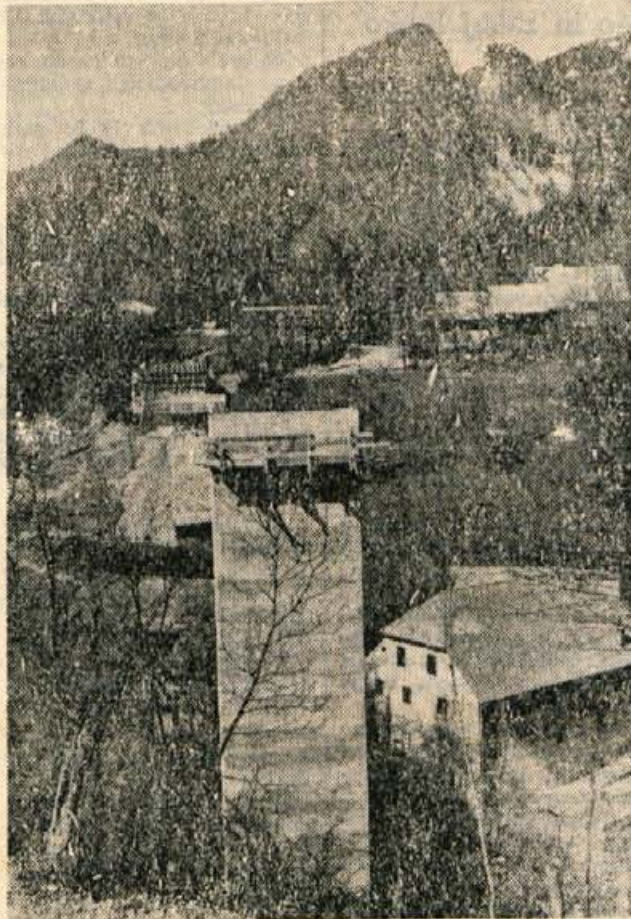
Dvema stebroma novega mostu čez Završnico se bo v kratkem pridružil še tretji in zadnji steber. Nov most bo dolg 142 metrov in bo kombinacija železnih nosilcev z betonsko ploščo. foto: F. Perdan
