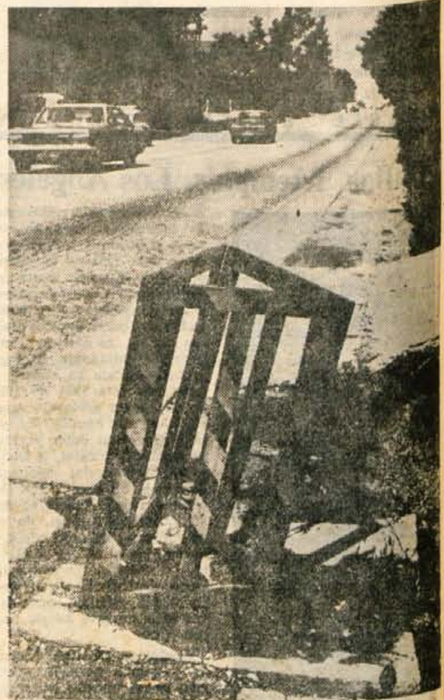
Ze dalj časa je, kar se je nasproti Vodovoda na Koroski cesti udria betonska plošča. Na nevarnost nas opozarja samo ograja, ki je postavljena na vdrtno. Tamkajšnji prebivalci se sprašujejo kdo je odgovoren za to in kdaj bodo to popravili. — Foto: F. Perdan
