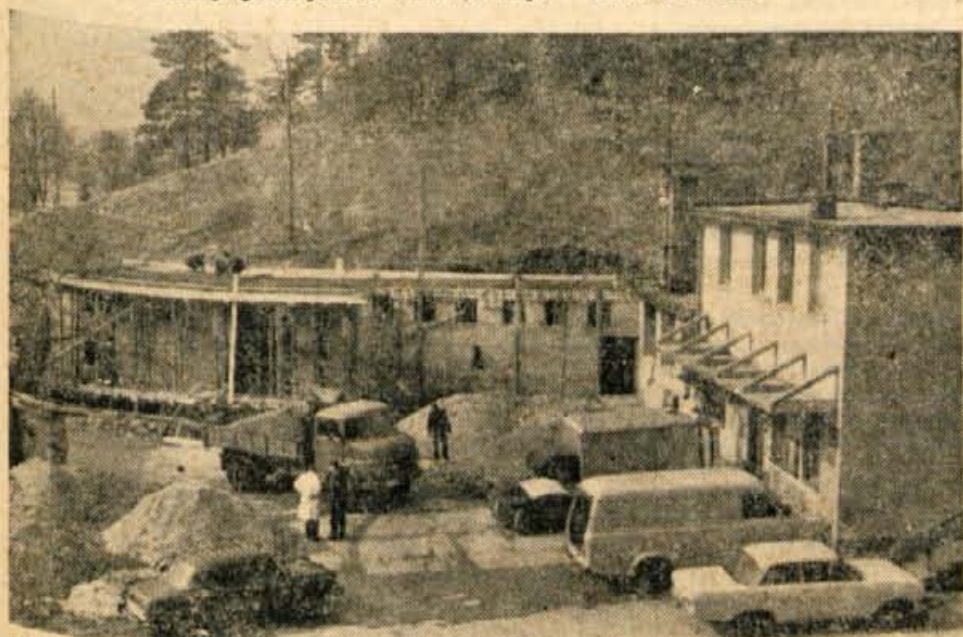
Cepprav je klavnica v Radovljici skoraj nova se je podjetje odločilo za dozidavo nove moderne prekaževalnice, skladišča za mesne izdelke in sanitarij za njihove delavce. Dela bodo veljala približno 70 milijonov starih dinarjev, ki jih je podjetje namenilo za to iz svojih lastnih sredstev. — Foto: F. Perdan
