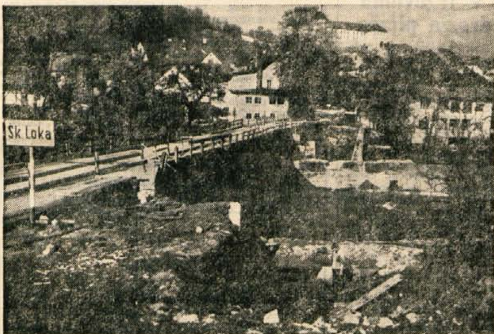
Pred štirinajstimi dnevi so delavci podjetja Tehnik iz Skofje Loke začeli graditi nov Puštalski most čez Poljansko Soro. Nov most bo dolg 36 metrov in širok 10,5 metra. Računajo, da bo zgrajen do avgusta. — Foto: F. Perdan
