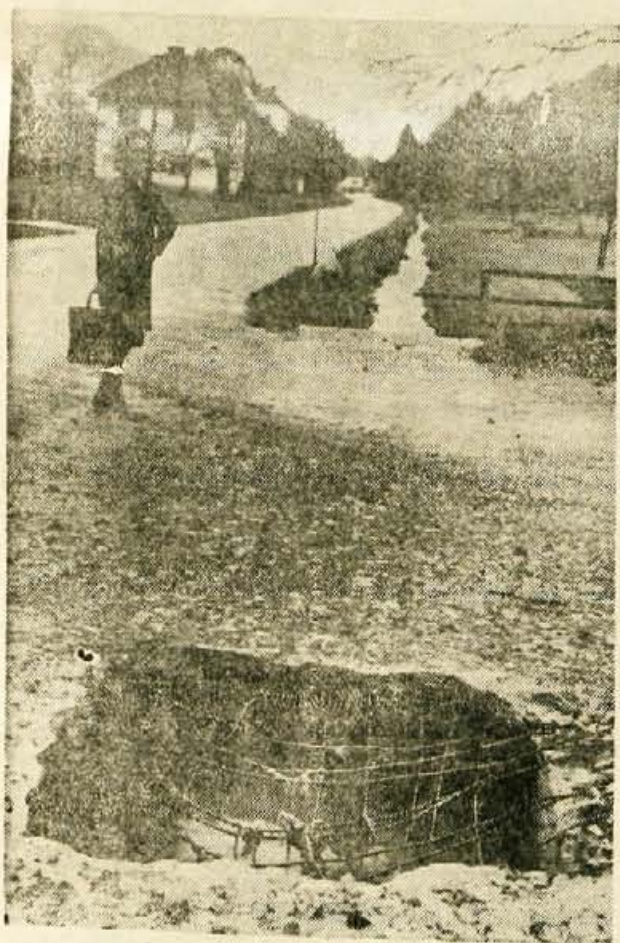
V Zg. Dupljah je pri gasilskem domu že pred časom avtobus poškodoval most. Nevarna vdrtnina še do danes ni popravljena. Prostovoljni gasilci v Zg. Dupljah pravijo, da bodo to poškodbo popravili skupaj z avtobusnim podjetjem SAP iz Ljubljane. Kaže pa, da so se o tem samo dogovorili in da se bodo del lotili šele, ko se bo zgodila nesreča. — Foto: F. Perdan
