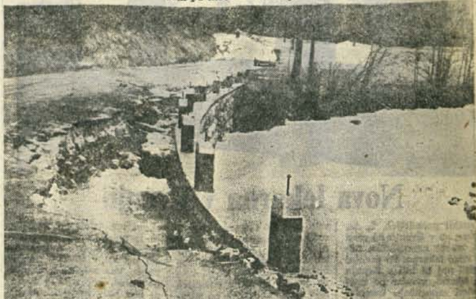
Na cesti na Jezersko, nekaj sto metrov nad Kanonirjem, je narasla voda takole poškodovala obrambni zid in cestnišče; zasifno so cesto takoj popravili — Foto Triler
