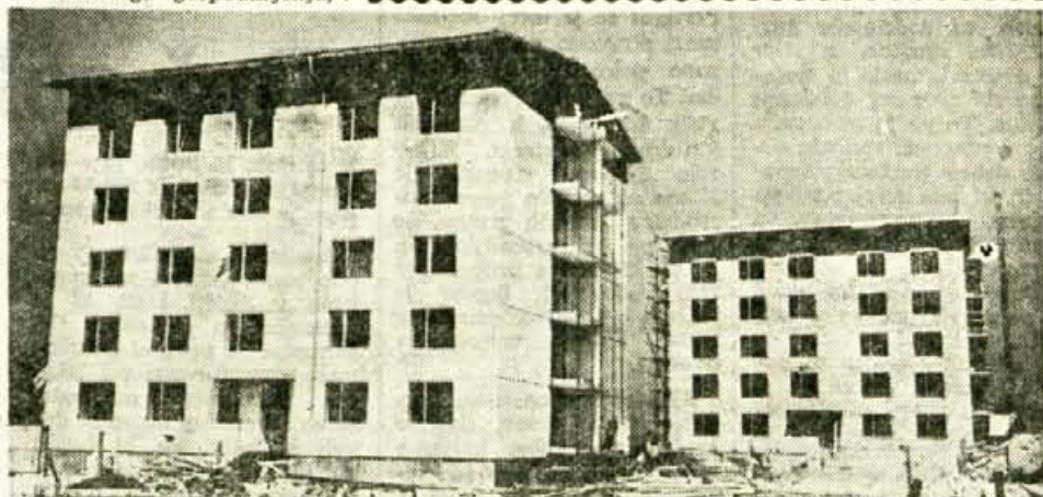
V Radovljici dograjujejo dva stanovanjska bloka, ki jih iz stanovanjskega sklada financira stanovanjsko podjetje. Eden bo v kratkem vseljiv, drugi pa približno čez mesec dni. Nekaj stanovanj v enem izmed teh dveh blokov bodo dobile stranke iz Grajskega dvora — Foto Perdan
