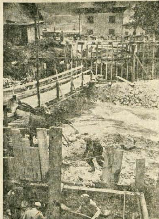
Naselje Podmežaklja na Jesenicah bo, kot obljublja, dobilo že z novim letom dobro zvezo s središčem Jesenic preko mosta, ki je v gradnji. Ta bo širok 11,5 m in 22 m dolg. zgrajen z montažnimi elementi in prednapetim betonom. To bo prva taka gradnja na Gorenjskem. Investitor je jeseniška občina, izvajalec del pa SGP Gradis, s svojo PE na Jesenicah
