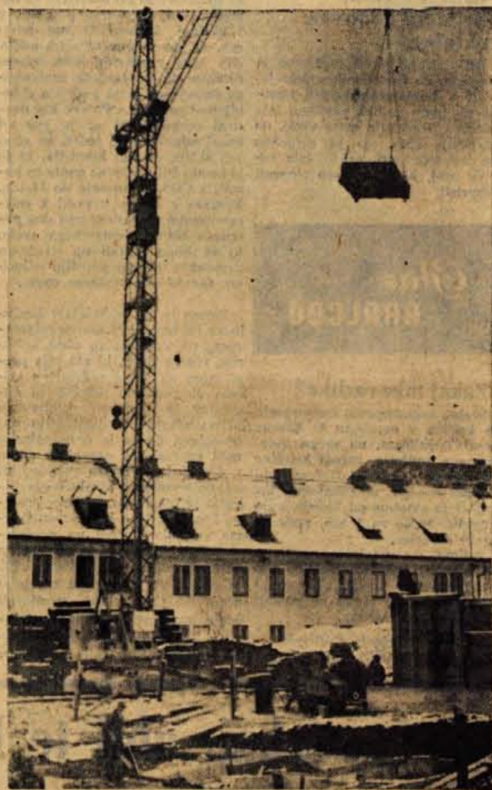
V Radovljici so pričeli z gradnjo štirih 5-nadstropnih stanovanjskih stolpčev. V vsakem bo 20 stanovanj, tako da bo vprašanje stanovanjskih površin spet izboljšano
