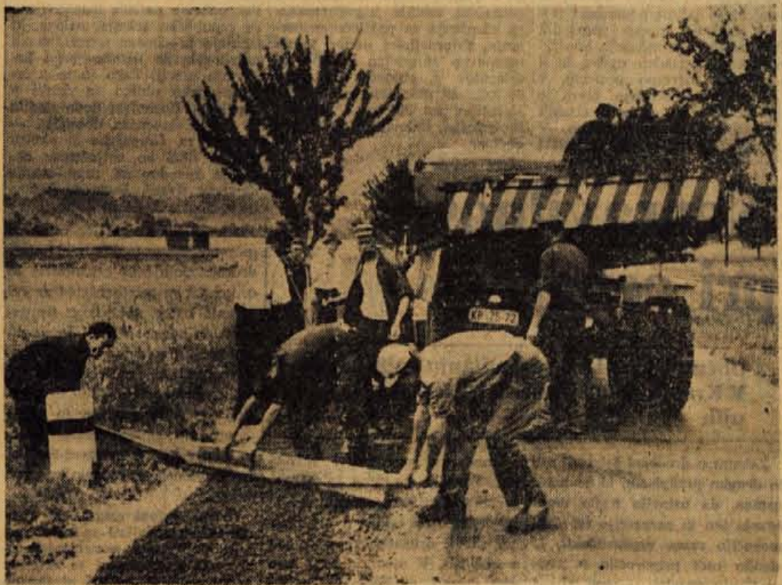
Delavci Cestnega podjetja so pred dnevi popravljali tržiško cesto v bližini vasi Krize. Kot vidimo na sliki, so se odločili za temeljito popravilo
