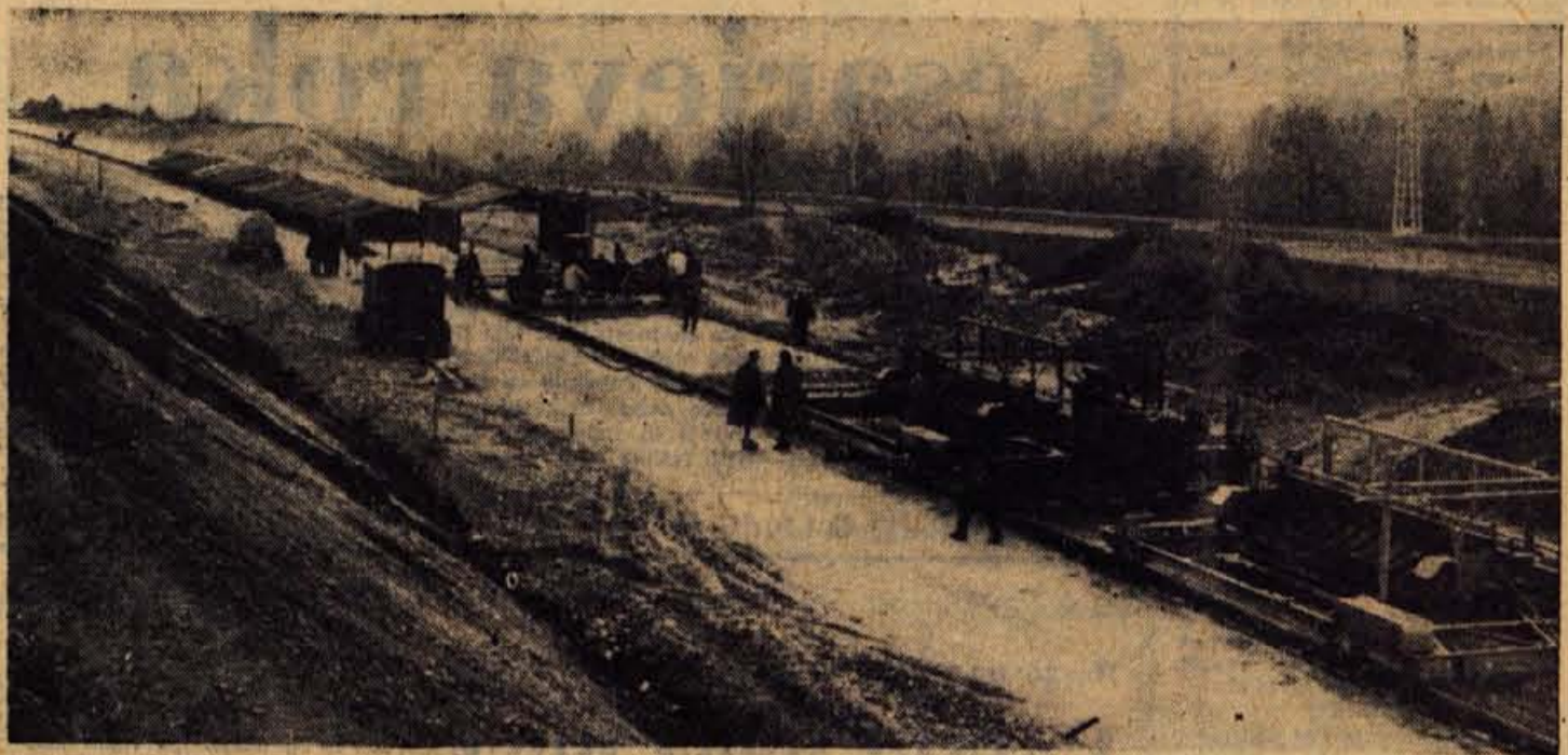
S. V Bistrici so pričeli betonirati prve metre nove gorenjske magistrale, ki bo povezala Gorenjsko s cesto Bratstva in enotnosti
