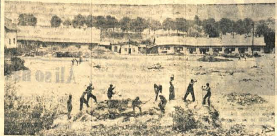
Jesenški športni park iz dneva v dan spreminja podobo. Mladí graditelji se neustrašno borijo s trdimi skalami. Na sliki jih vidimo pri gradnji pomožnega nogometnega igrišča pod Mežakljo
