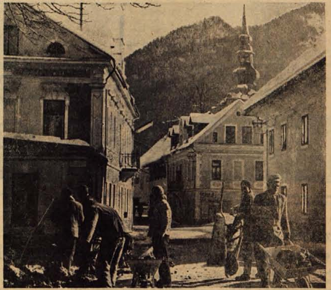
Kanalizacija in vodovod sta za Kranjsko goro še vedno precejšnja problema. Zadevo pa z velikim prizadevanjem vse hitreje urejajo
