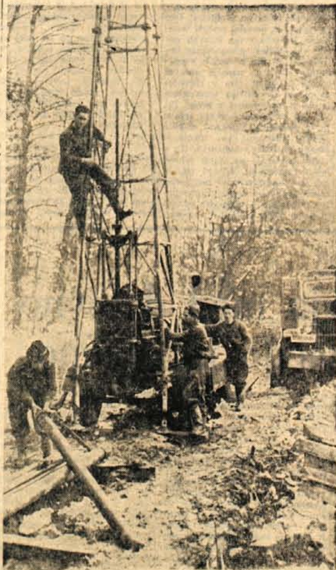
V Ljubnem se te dni zdržuje skupina strokovnjakov Inštituta za raziskavo materiala in konstrukcij. S sedanjnimi deli pregledujejo teren, na katerem naj bi že prihodnje leto začel z gradnjo nove ceste skozi Gorenjsko
