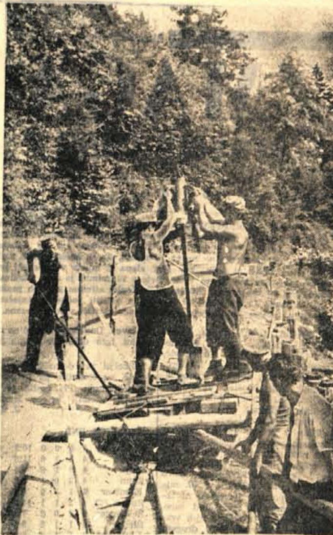
Cesta, ki pelje iz Skofje Loke proti Poljanski dolini, se je začela na nekaterih mestih pogrezati. To pa je sveda precej oviralo promet, tako da so jo morali ob slabem vremenu, ko so se nanjo posipali zemeljski plazovi, celo zapreti. Cestno podjetje iz Kranja je te dni začelo popravljati tiste odseke cesti, ki so najbolj nevarni, da bi se ob slabem vremenu spet pogrezali.
