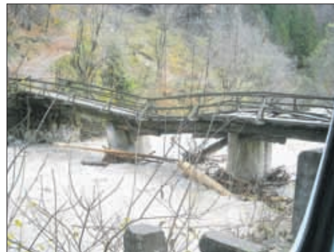
Pobesnena reka Kokra je ogrozila ceste in mostove.
