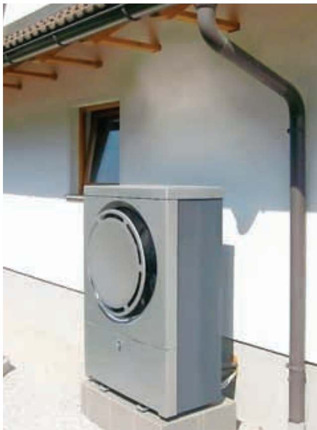
Zunanja enota toplotne črpalke Thermia Atec 13
