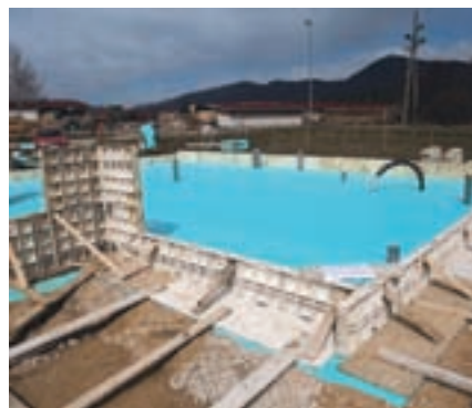
Drugi sloj toplotne izolacije FIBRANxps 400-L ščiti hidroizolacijo pred poškodbami. Položen je v opaž temeljne plošče
