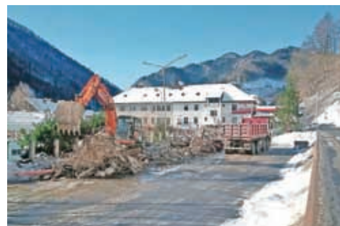
Takole so v podjetju Alples porušili vratarnico in pokrita parkirišča, ureditve križišča pa se bo občina lotila v prihodnjih letih. / FOTO: ANDREJ TARFILA
