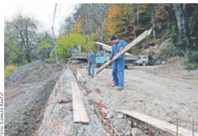
Dela na cesti skozi Strmico, kjer jo je ogrozil plaz.
