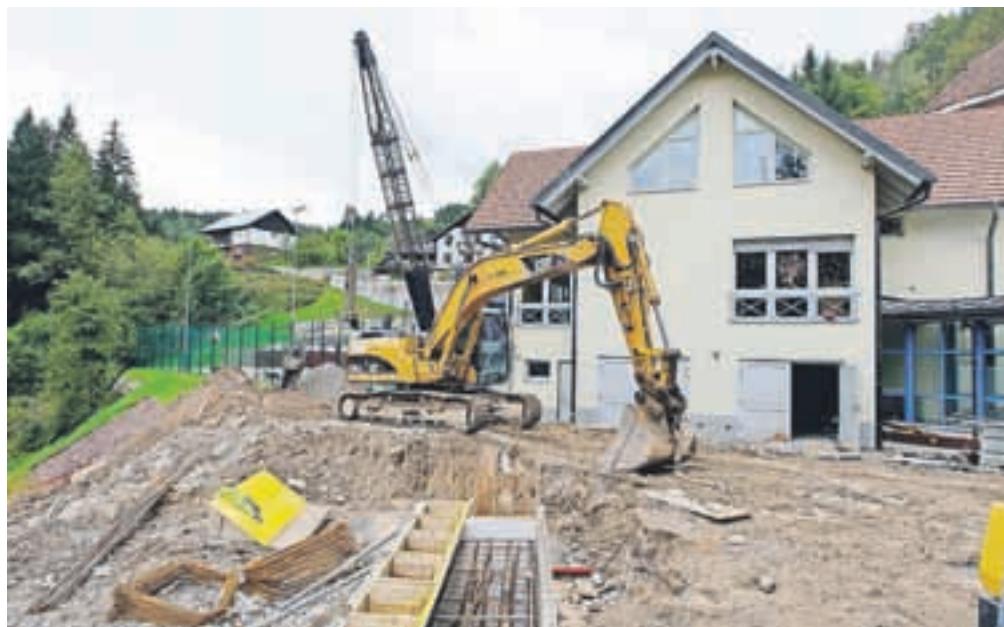
Sanacija plazu pod šolo na Sovodnju bo kmalu končana, sledi sanacija poškodovanih delov (nove) stavbe. /FOTO: DENIS BOZOVIČAR
