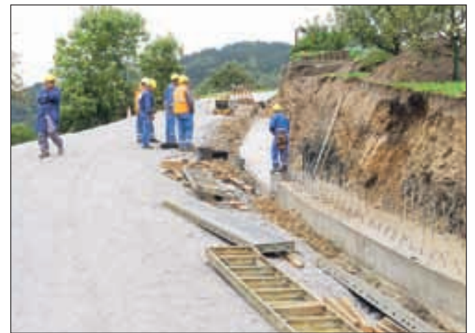
Gradnja vodovoda in kanalizacijskega sistema v vaseh pod Starim vrhom je zaključena, dela na cesti pa bodo potekala vsaj še mesec dni. / FOTO: DENIS BOZOVIČAR
