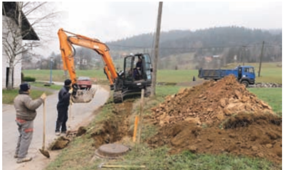
Konec prejšnjega tedna se je končno začela gradnja kanalizacije v Rakulku in na Dobračevi.
