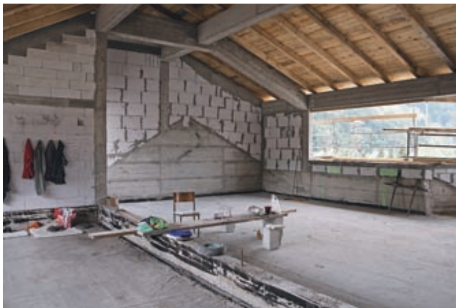
Nadzidava šole poteka po terminskem planu oziroma celo nekoliko hitreje. / Foto: Polona Mlakar Baldasin
