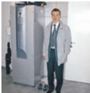
TČ na zemeljski kolektor Utik
