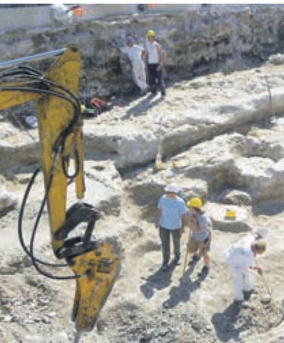
Uničene arheološke najdbe na gradbišču v Kranju
