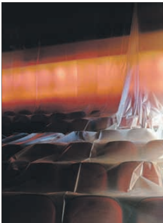
Nekoliko nevsakdanji pogled v dvorano Prešernovega gledališča ponujajo z zaščitno folijo prekrite sedeži, v delu je namreč prenova odrskih vlakov.
