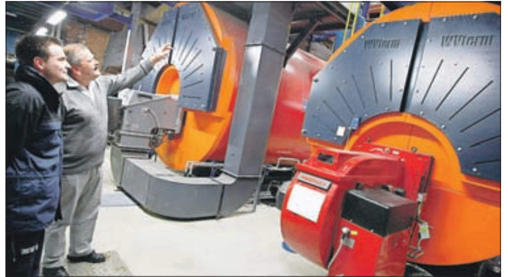
Nova kotla v toplarni na Planini že obratujeta. / FOTO: GORAZD KAVČIČ
