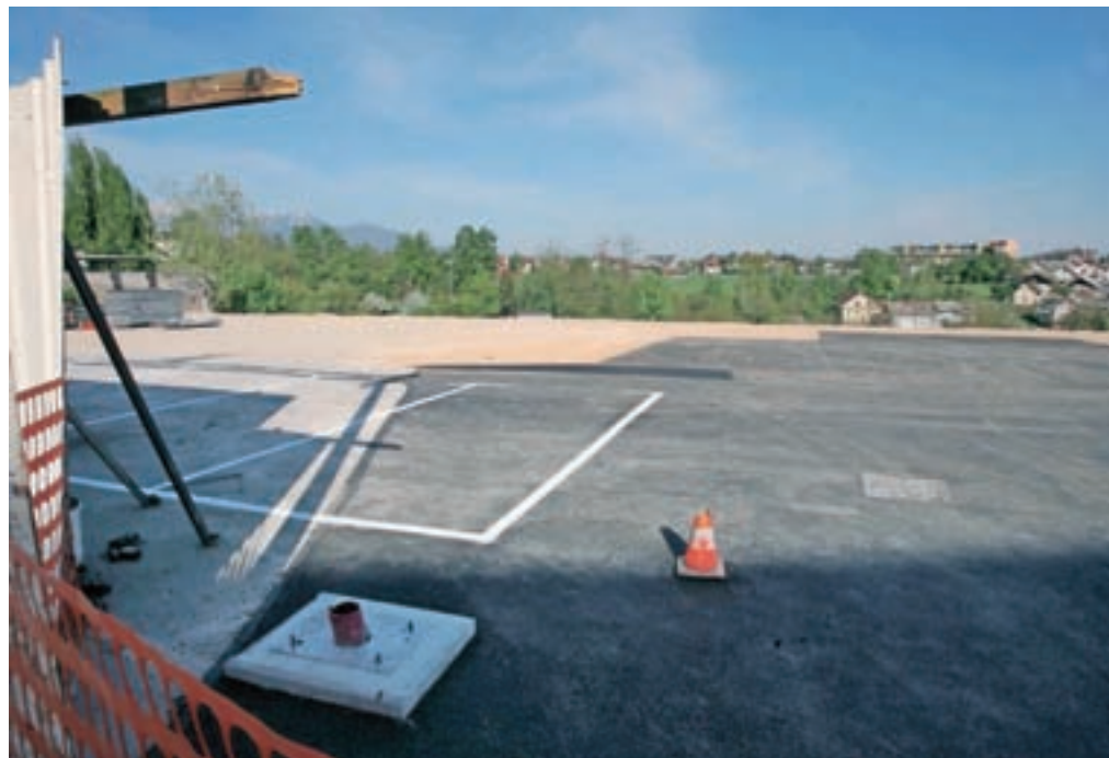
Parkirišča na Stari Savi se urejajo in jih bo moč uporabljati že v maju. / FOTO: TINA DOKL
