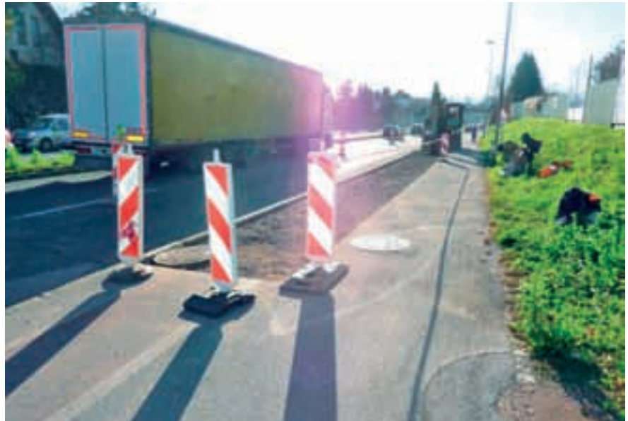
Po sanaciji ne bo več nevarnega roba med kolesarsko stezo in pločnikom.
