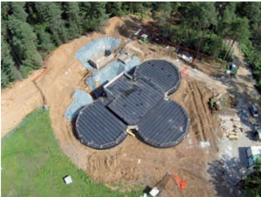
Vodohran Zeleni hrib v okviru gradnje vodovoda Bašelj-Kranj – opravljena je večina del na objektu.
