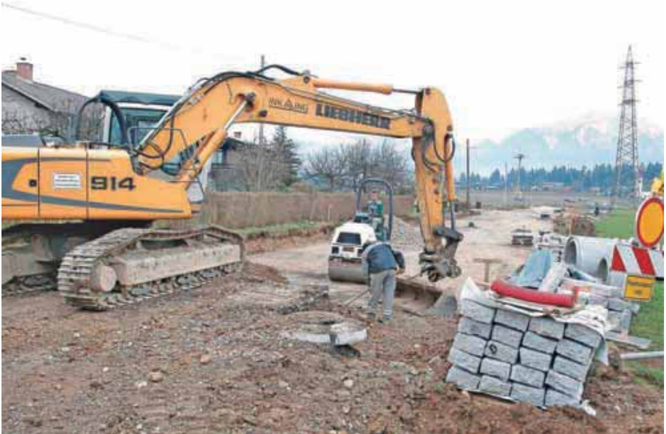
Gradnja pri projektu Gorki in vodovodu Bašelj - Kranj poteka po načrtu. / Foto: Gorazd Kavčič
