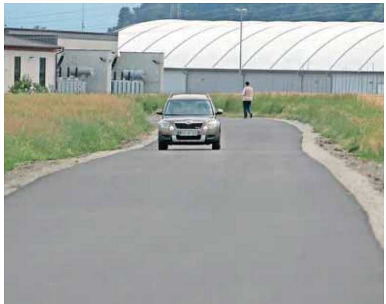
Pred kratkim so asfaltirali cesto od transformatorja na Zlatem polju do Kalije, v drugi fazi je predvidena še gradnja pločnika in javne razsvetljave.
