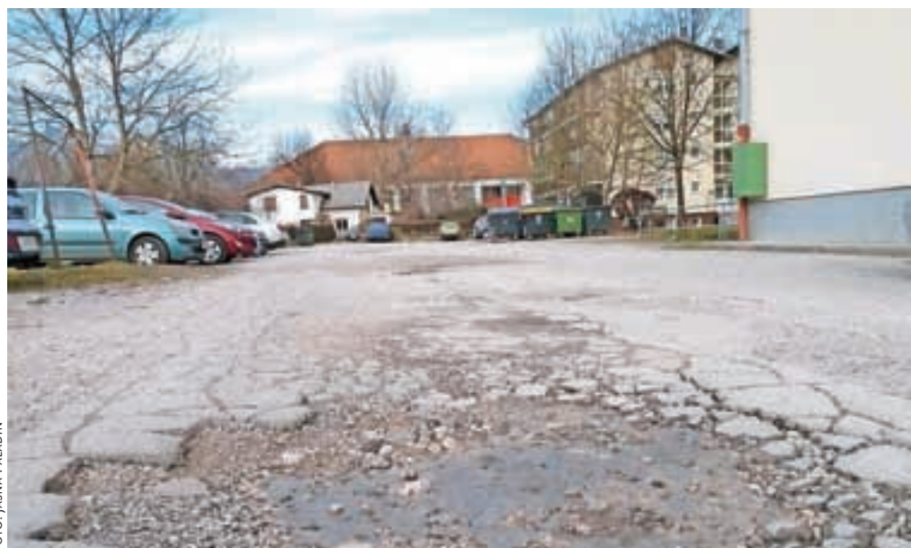
Parkirišče na območju Tunjiške ceste je eno zadnjih še neasfaltiranih parkirišč v mestu.
