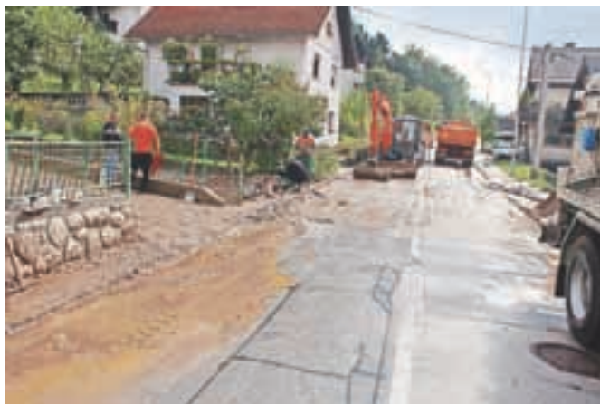
Bregove je prestopil manjši hudournik Čopov graben na Cesti Toneta Tomšiča na Jesenicah. / FOTO: ANDRAŽ SODJA
