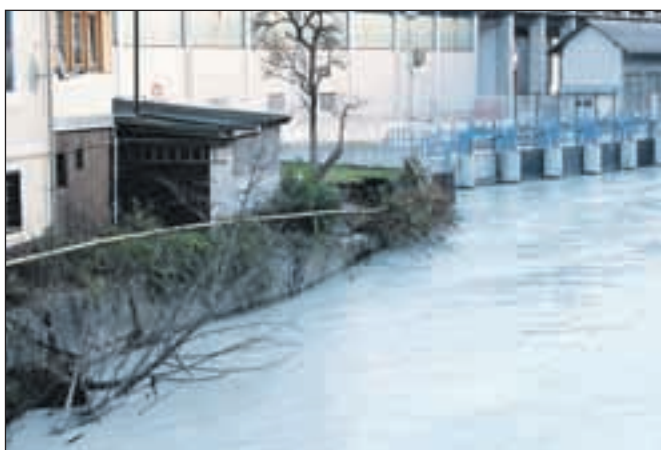
V Podmežakli je voda spodjedla betonsko ograjo gostinskega lokala in obrežje.
