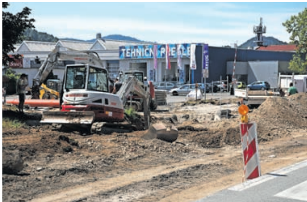
Obnova Kidričeve ceste trenutno poteka v okolici Tehničnih pregledov, kjer bo tudi križišče. / Foto: Gorazd Kavčič
