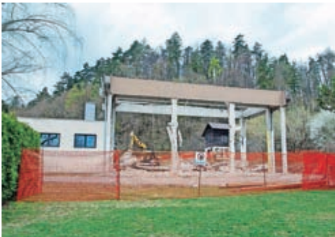
Objekt bo dokončno porušen v teh dneh.
