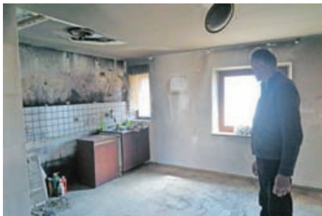
Hiša po požaru ni več primerna za bivanje.
