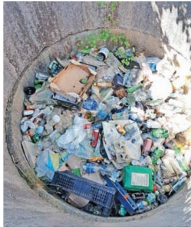
Betonsko cev, v kateri se kopičijo odpadki, naj bi zaprli oziroma odstranili.
