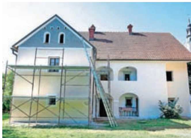
Rojstna hiša Ignacija Borštnika počasi, a vztrajno dobiva prenovljeno podobo. Te dni so obnovili severno fasado.
