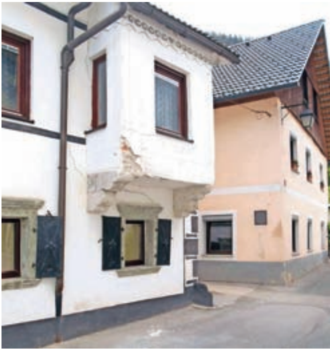
Trk avtobusa je na Barglrovi hiši pustil razpoke in poškodovano »prižnico«.
