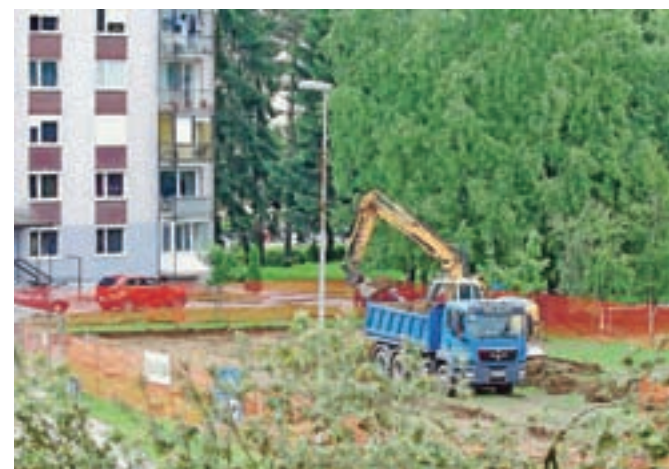
Parkirišče v Šorlijevem naselju so prejšnji teden vendarle začeli graditi. / Foto: Tina Dokl
