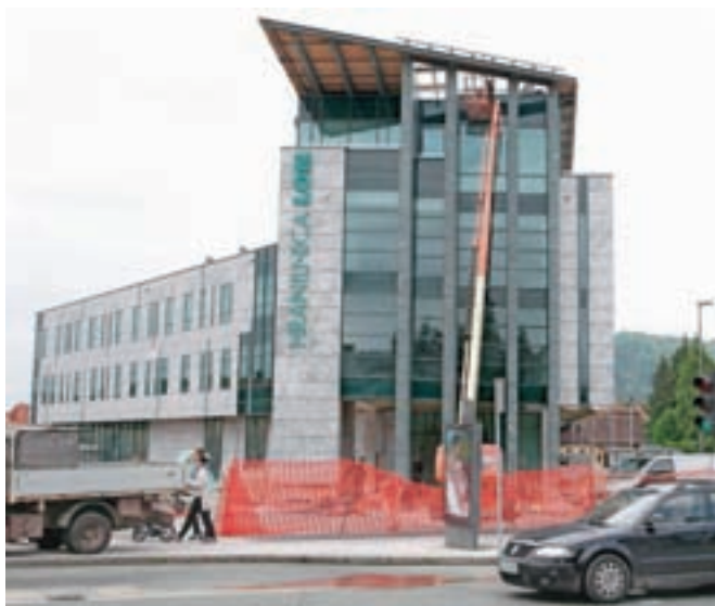
Hranilnica Lon gradi ob Cesti Staneta Žagarja v Kranju novo poslovno stavbo, v kateri bodo za delo boljši pogoji kot v sedanjih utesnjenih prostorih. / Foto: Gorazd Kavčič
