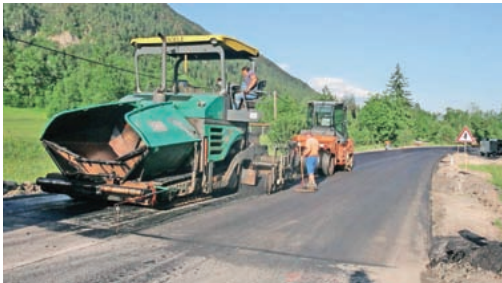
Delavci Gorenjske gradbene družbe so z zadnjimi deli pri obnovi cestnega odseka med Hrušico in Mojstrano hiteli ves pretekli konec tedna. / Foto: Tina Dokl
