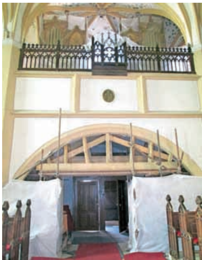
Ker so stebri pod pevskim korom v radovljiški cerkvi sv. Petra v zelo slabem stanju, so jih oktobra morali okrepi in kor podpreti z leseno konstrukcijo.
