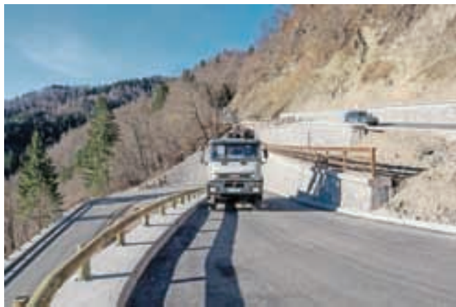
Regionalno cesto Podrošt–Sorica so včeraj spet odprli za promet, dela pa se bodo končala spomladi, ko bodo položili še zaključni sloj asfalta. / Foto: Andrej Tarfla
