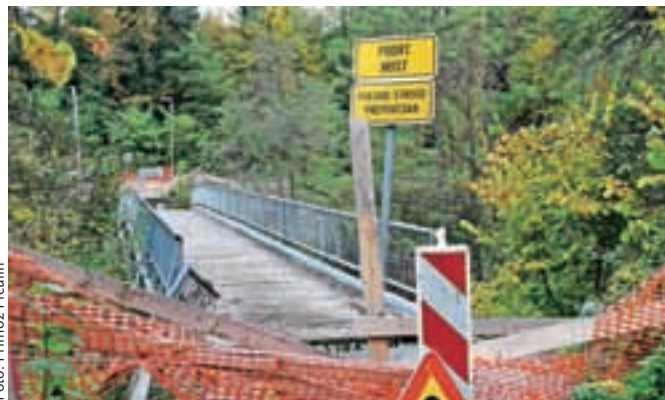
Most na Hujah je še vedno poškodovan in zaprt.
